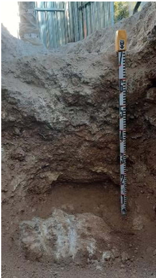
Fotografia 14: detall de secció on es veu la base de formigó de l'eix de la porta (UE 705) i, el nivell geològic calcari de la muntanya del Park Güell (UE 1000).
