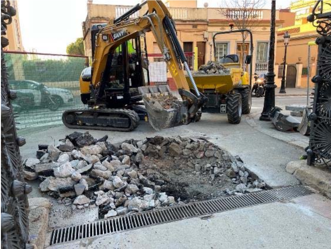
Fotografia 57: inici de les obres a la porta Monumental d'Olot. Extracció UE 900 i 901.
