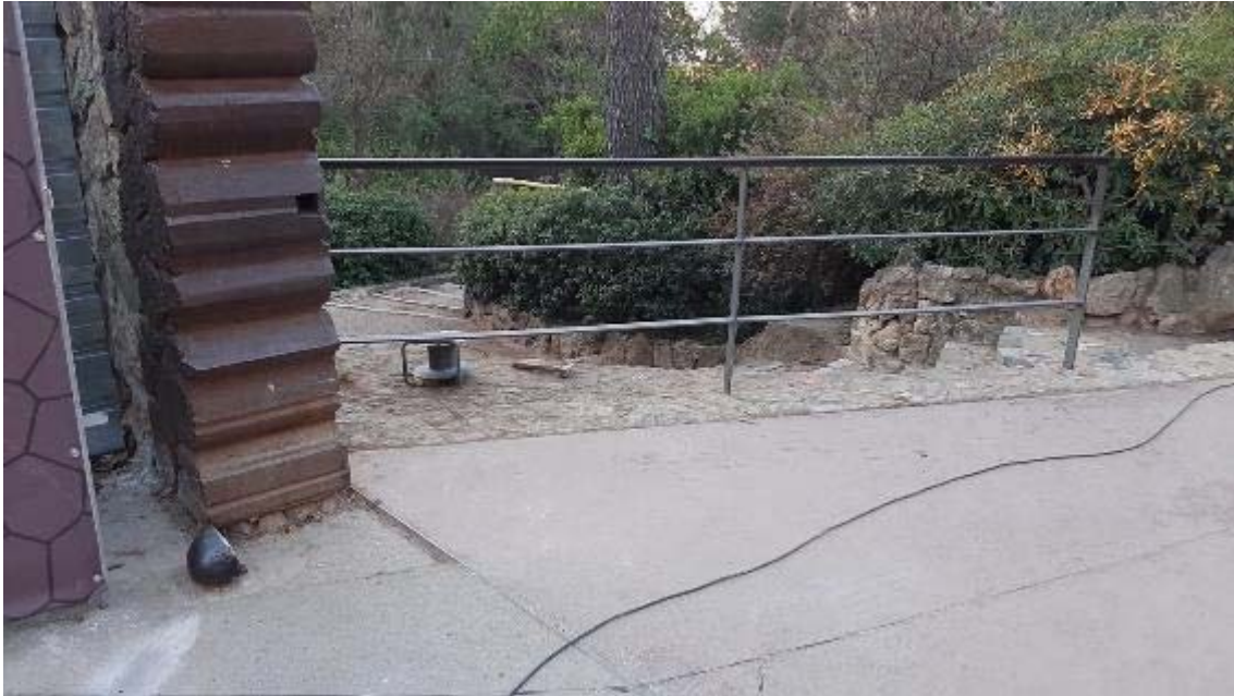
Fotografia 21: localització del topall de la Cala 3.
