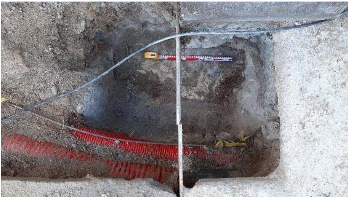
Fotografia 18: final obra de la Cala 1. S'identifica a la part inferior del rebaix el geològic (UE 1000) calcari de la muntanya del Park Güell, juntament amb el retall (UE 714) dels tubs elèctrics que retallen la base de formigó de l'eix de la porta (UE 705).
